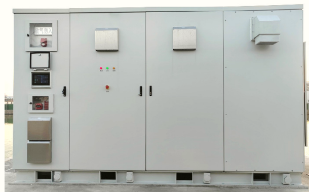
图9 宁波市首座钠锂离子联合电池台区储能电站
