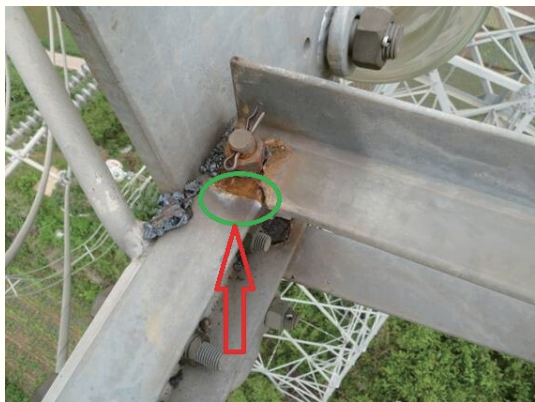
图2 现场拍摄相片金具出现灼烧痕迹
