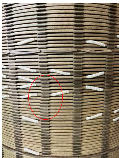
图5 高压绕组垫块偏移情况
