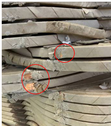
图7 A相中压绕组绝缘损坏情况
