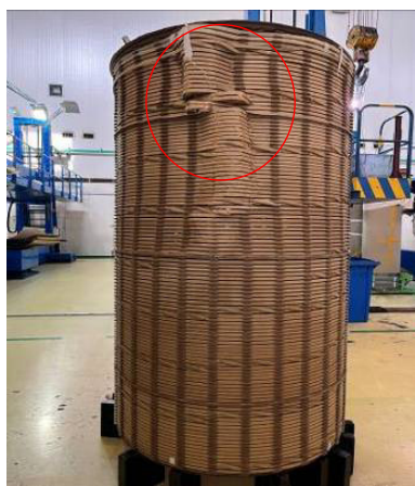
图6 A相中压绕组变形情况
