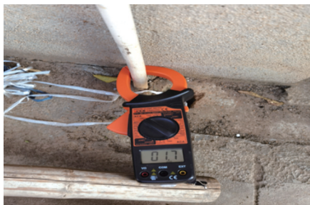
图3 路灯线漏电1.7 A
