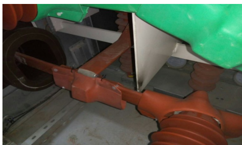
图2 开关柜局部放电情况
