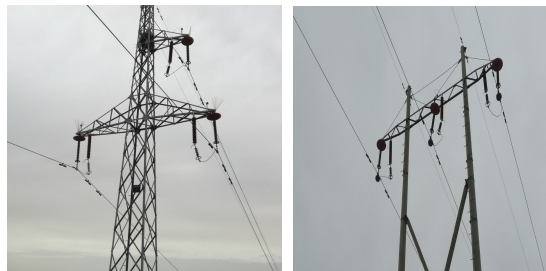
图11 XLQW/110-II型110 kV线路雷击钳位保护器安装
